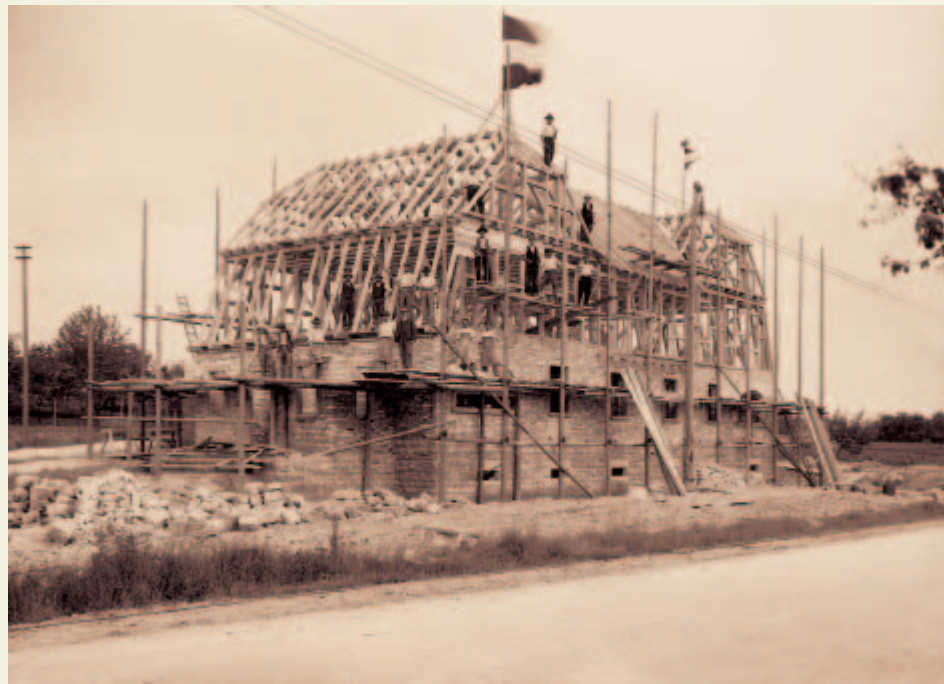
1903 - auf dem etwa 100 ha großen Gelände wird mit Bauarbeiten begonnen - ein Gebäude kostet rd. 110 Tsd. Reichsmark
